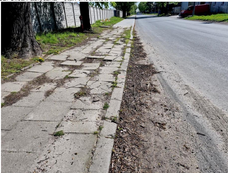
Fotografia 32. Ulica Fabryczna – stan chodników
