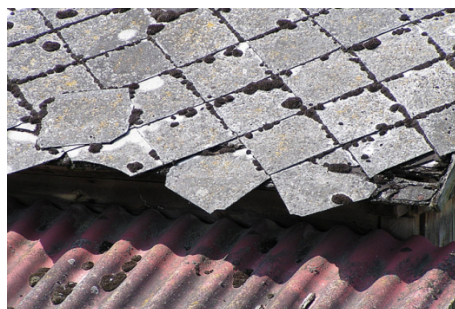
Rys. 8. Pokrycie dachowe ocenione w I stopniu pilności.
