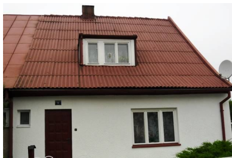
Rys. 6. Pokrycie dachowe ocenione w III stopniu pilności.
