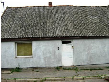
Rys. 7. Pokrycie dachowe ocenione w II stopniu pilności.
