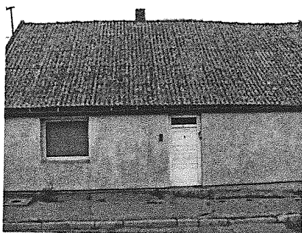
Rys. 7. Pokrycie dachowe ocenione w II stopniu pilności.
