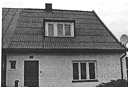
Rys. 6. Pokrycie dachowe ocenione w III stopniu pilności.
