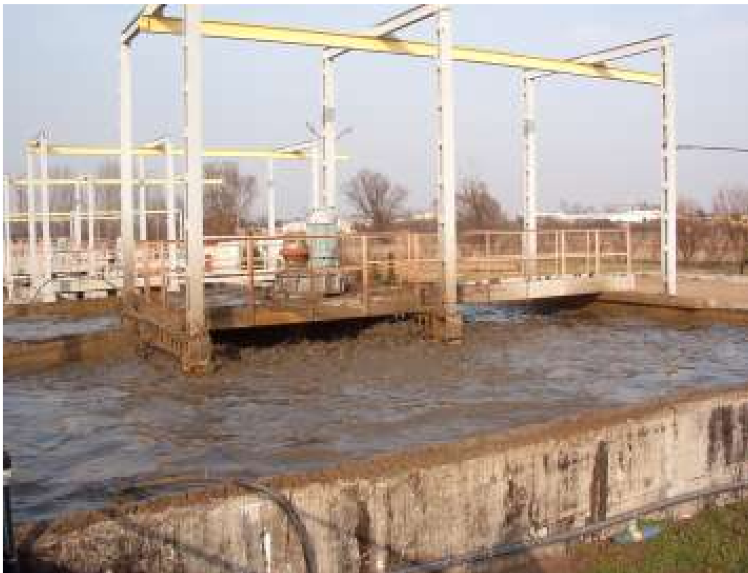
Widok komory fermentacji oczyszczalni SDM
